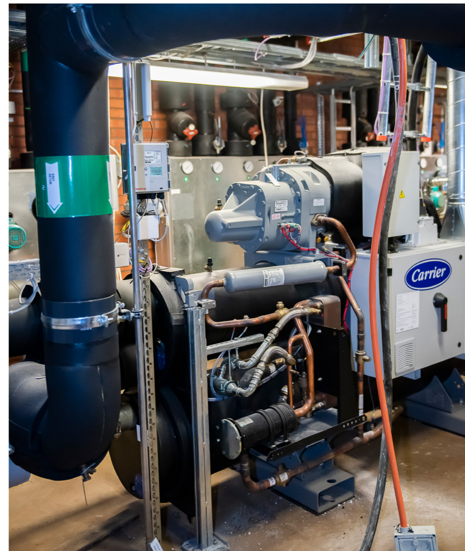
En värmeväxlare i Centriahuset ser till att överskottsvarmen från kylanläggningen återförs till fjärrvärmenätet.
